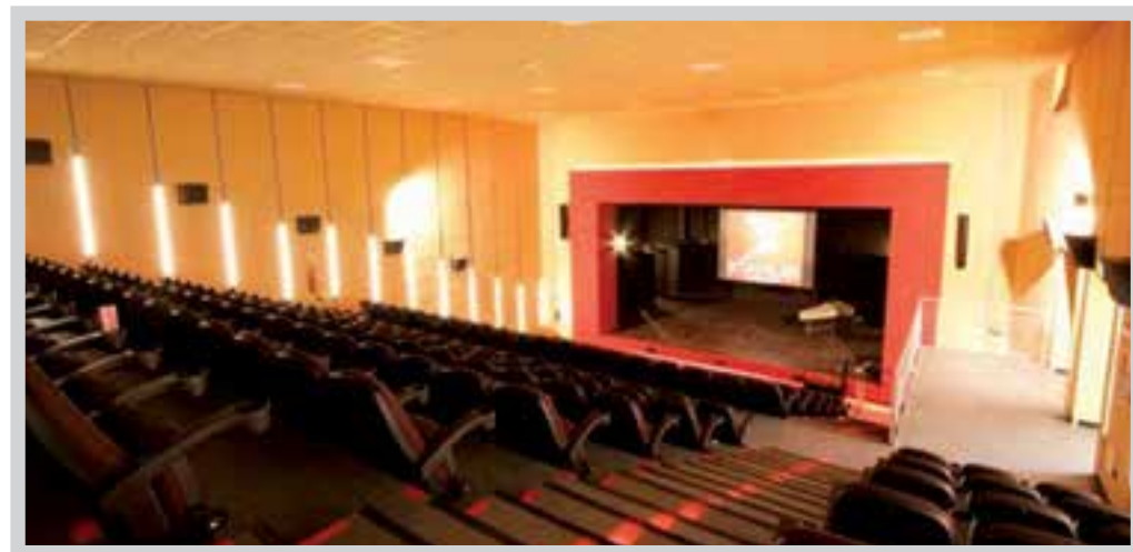
Cinema Politema Saluzzo - Realizzazione di: impianto audio per l'evacuazione sonora e per eventi/conferenze - sistema di proiezione
